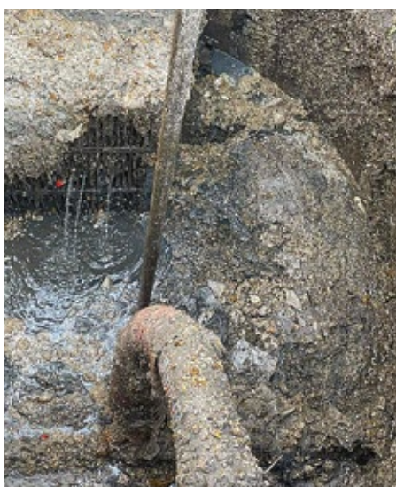
Vstupná odpadová šachta ČOV
