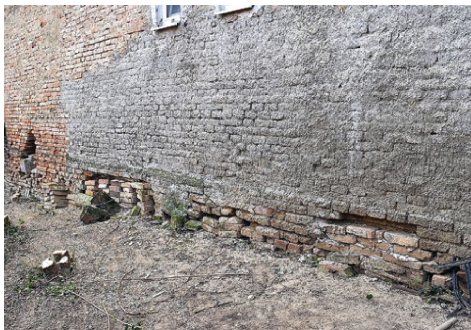
Narušená statika múru budovy OcÚ
